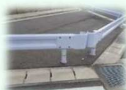
ガードレール [例]曲がり、ゆがみ
