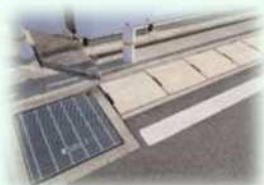
道路側溝・集水枡 [例]側溝蓋のガタツキ
