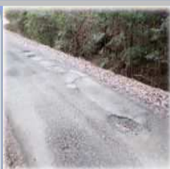
舗装の穴ぼこ・陥没
