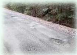
路面穴ぼこ・陥没 [例]路面段差
