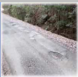
舗装の穴ぼこ・陥没
