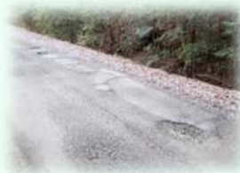
路面穴ぼこ・陥没 [例]路面段差
