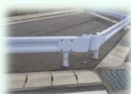
ガードレール [例]曲がり、ゆがみ
