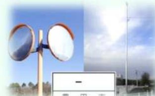
カーブミラー・照明灯 [例]角度調整、不点灯 ※豊田市管理ステッカーが貼ってあるもの
