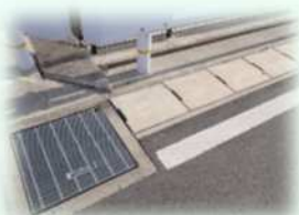
道路側溝・集水桧 [例]側溝蓋のガタツキ
